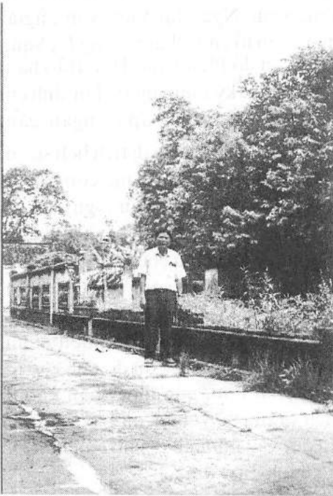
Hình 6. Tác giả đứng bên cạnh tường rào phía tây lang. Tường đã sụp đổ, sân tráng xi măng sụp bể chưa được sửa chữa, cỏ mọc um tùm, hoang phế.
