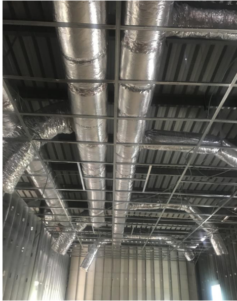
Hệ thống ống và máy lạnh đã lắp đặt
